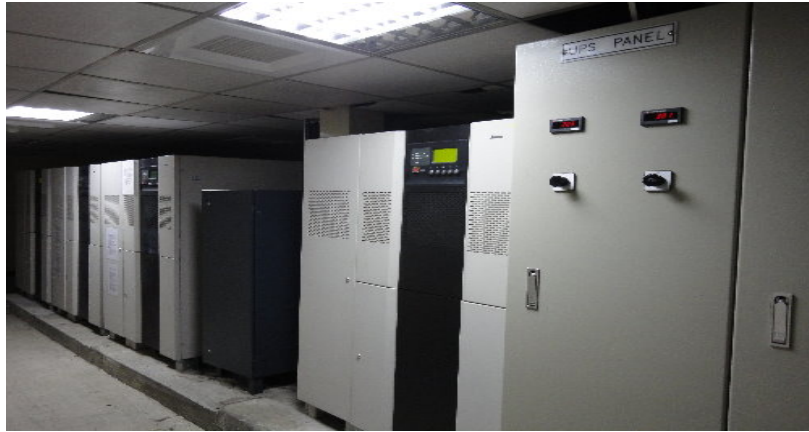
圖一：電器室 UPS 設備
