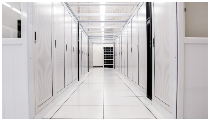
圖二：本機房所使用機櫃式空調
