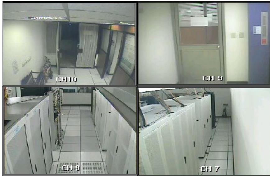
圖五：本機房之監視器
