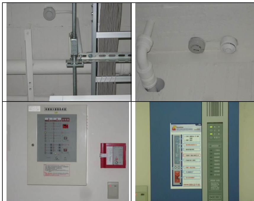
圖四：本機房的消防警示系統
