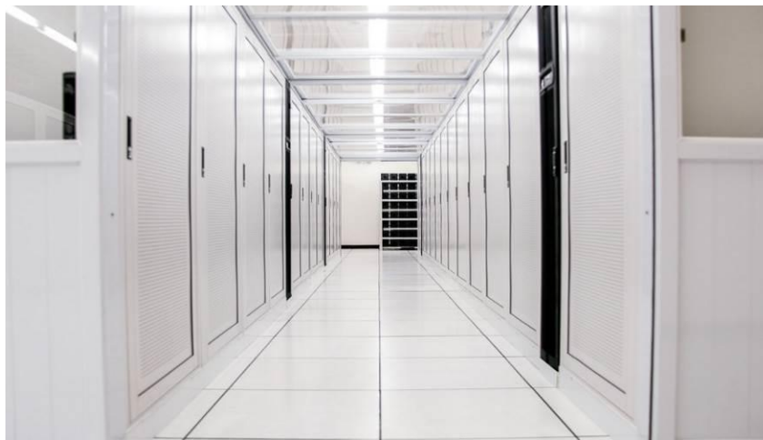
圖二：本機房所使用機櫃式空調
