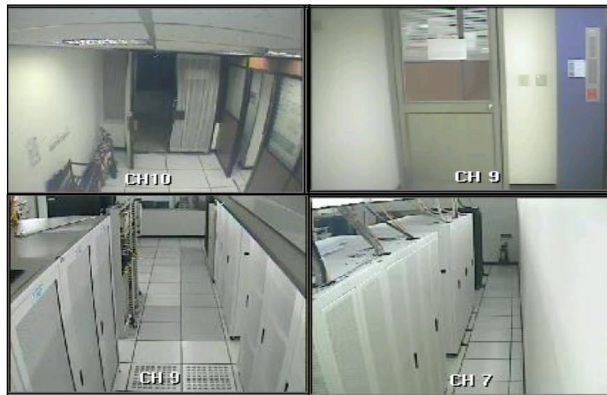
圖五：本機房之監視器
