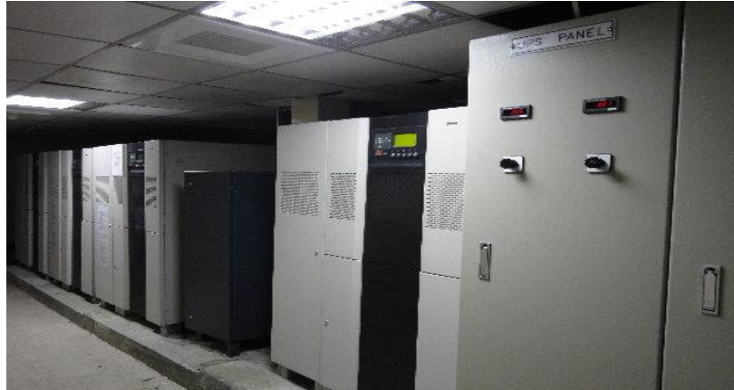
圖一：電器室 UPS 設備
