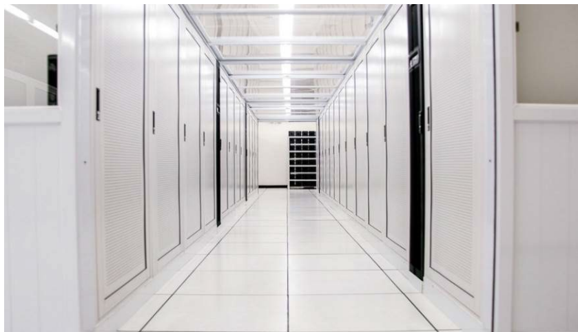
圖四：本機房所使用機櫃式空調
