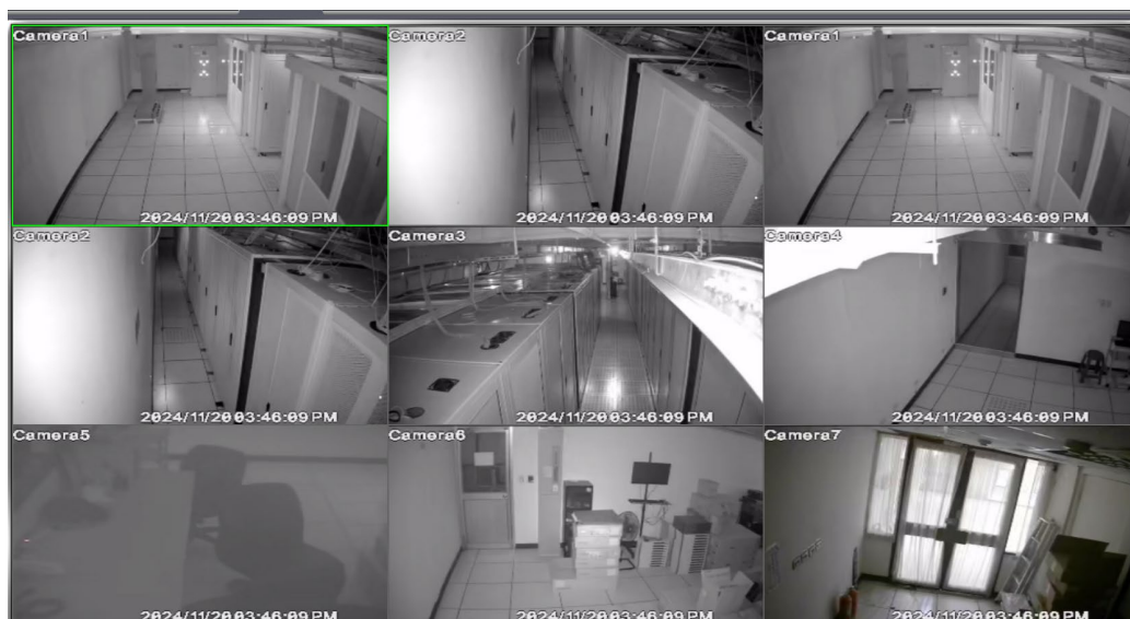
圖七：本機房之監視系統
