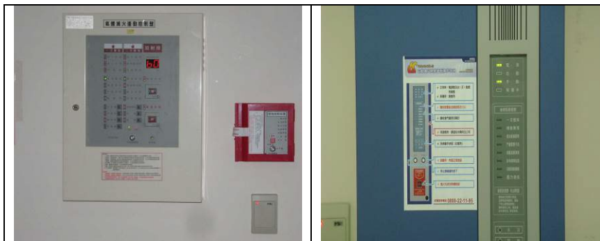
圖六：本機房的消防警示系統
