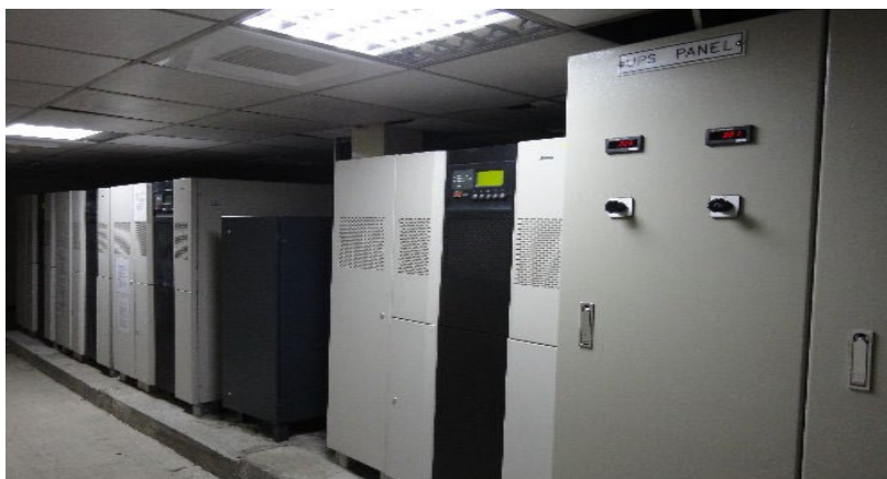
圖三：電器室 UPS 設備
